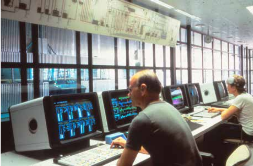
Valmetin Damatic-järjestelmällä toteutettu valvomo 1970-luvulta.
